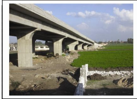
صورة (٢١) أحد المنشآت التي قامت على أرض زراعية - كوبرى تحت الإنشاء - وصدر له ترخيص بناء، مدينة كوم حمادة (مركز كوم حمادة).
