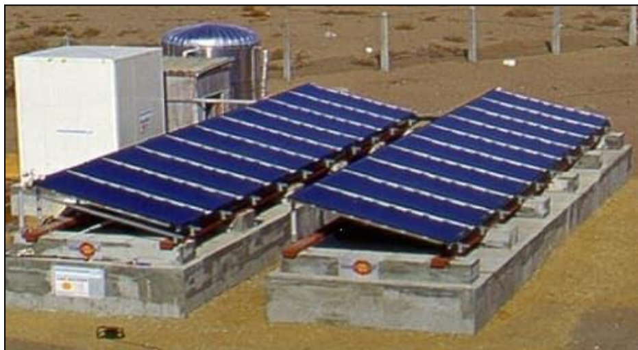
شكل (3-10): وحدة معالجة مياه بالطاقة الشمسية
